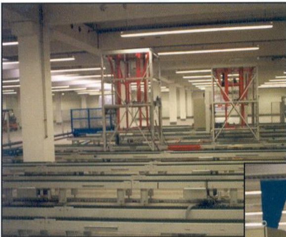
Fördertechnische Anlage mit Kettenförderern und Stapel-Magazinen
